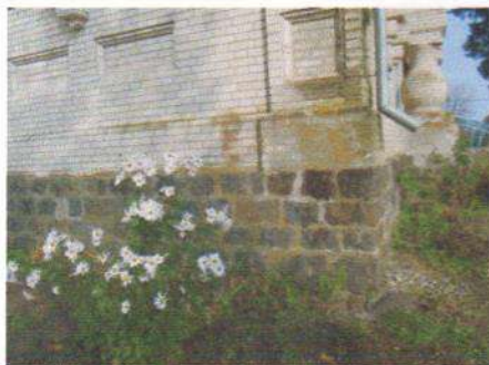
С.Великі Крушлинці, Вінницького р-ну, Вінницької обл. Храм Усікнення голови Іоанна Предтечі. Деталь екстер'єру: фундамент. Листопад 2013р.
