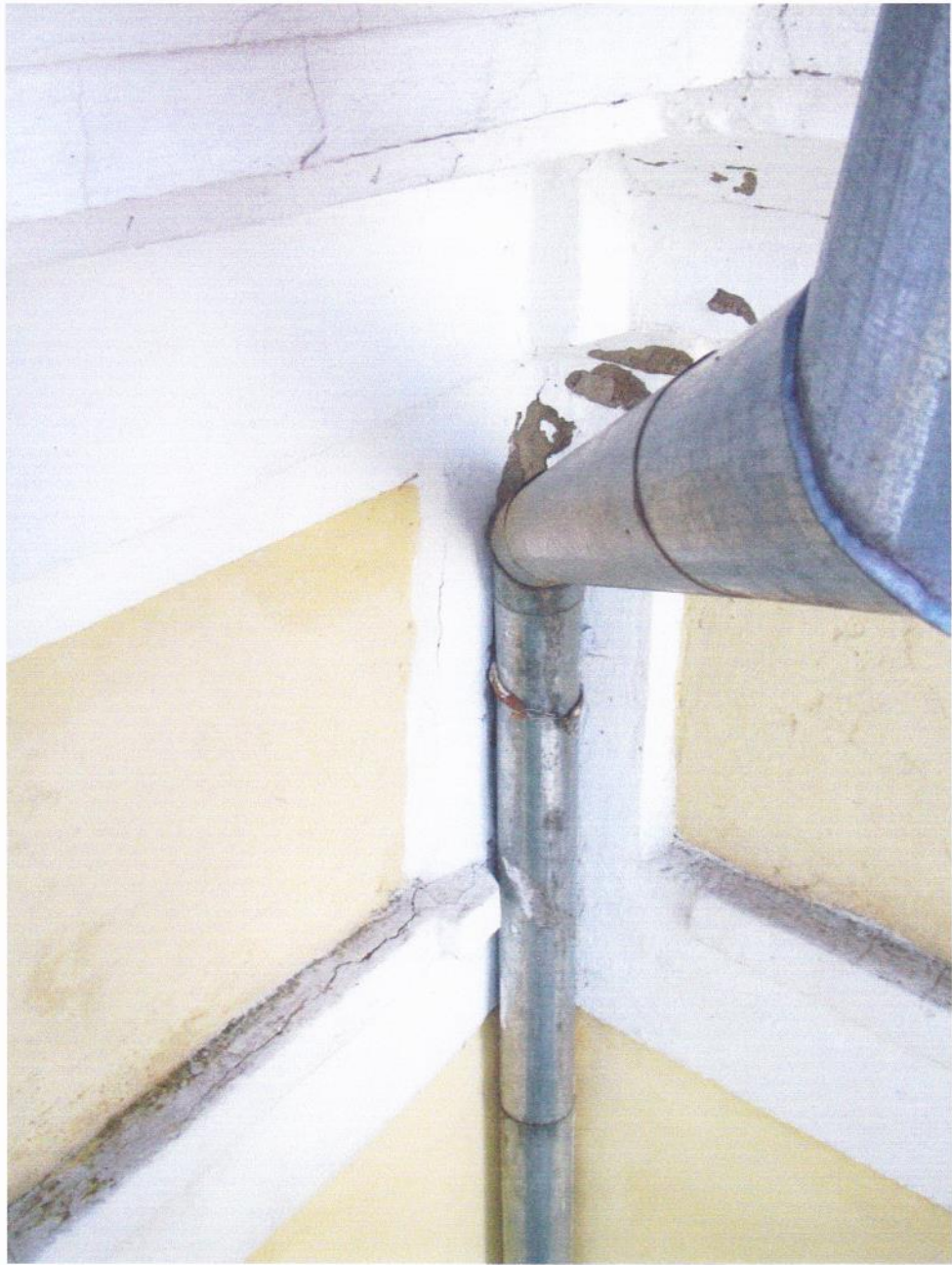
П'ятничани. Фрагмент водовідведення головного фасаду палацу. Березень 2013р.
