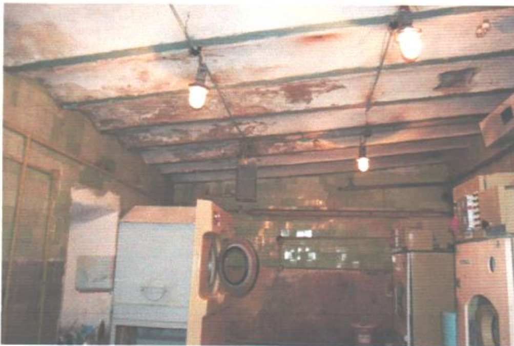
П'ятничани. Інтер'єр. Циліндричне склепіння між металевими балками над пральною денного стаціонару. Західне крило стайні.(Флігель палацу). Квітень 2013р.
