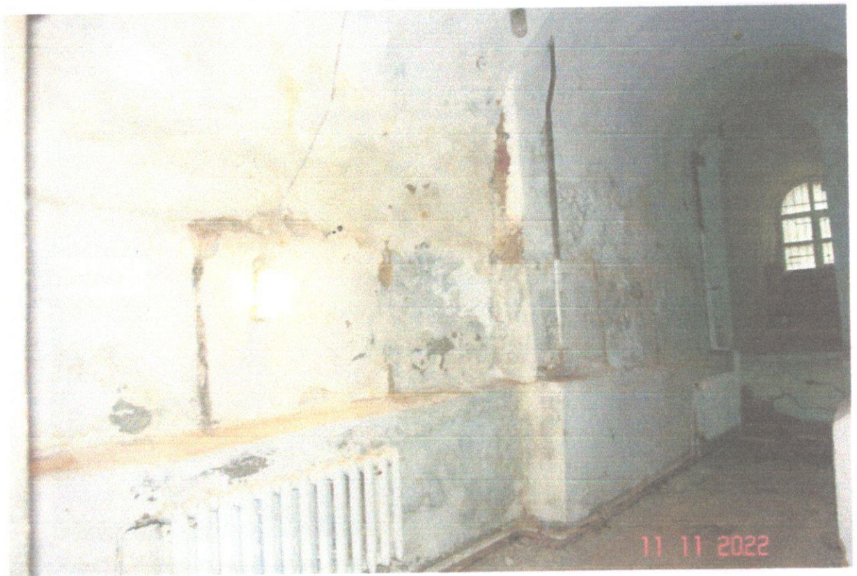
Фото 8. Грибок штукатурки стін підвалу.
