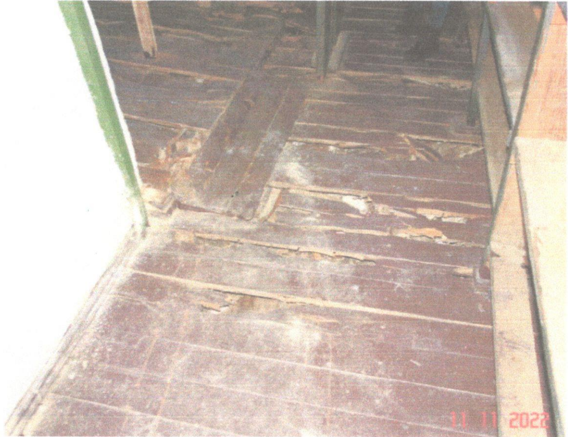
Фото 6. Руйнування дощатої підлоги північної частини підвалу.
