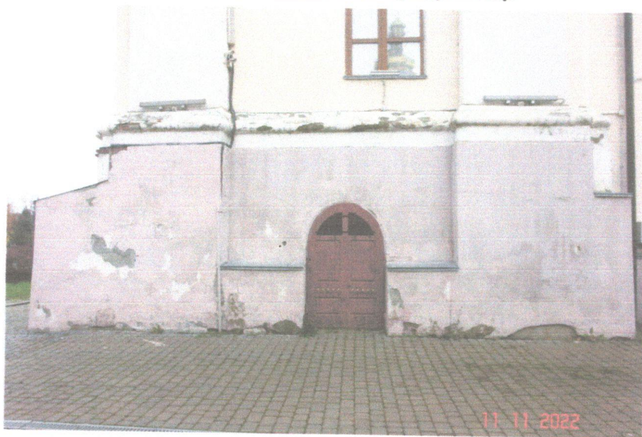
Фото 4. Фрагмент західного фасаду костьолу (руйнування декоративного пояса та штукатурки цоколя).
