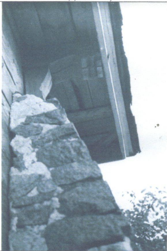
м. Вінниця, Миколаївська церква, дзвіниця, фрагмент контрфорсу та зрубу 1961р. (фото з архіву Л.Денисової)
